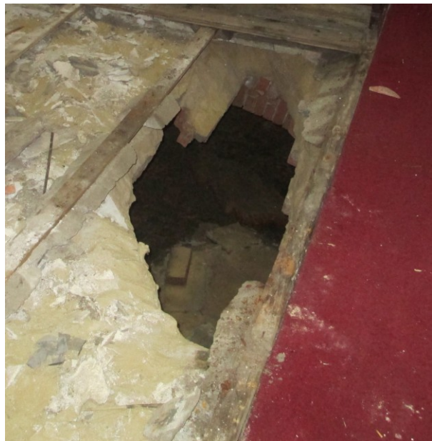
Het gat in de vloer onder de achterste kerkbanken. Een van de bogen is zichtbaar.
