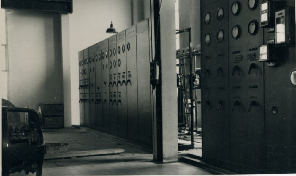
Nieuw turbinegebouw. Nieuw schakelbord turbine 4.
