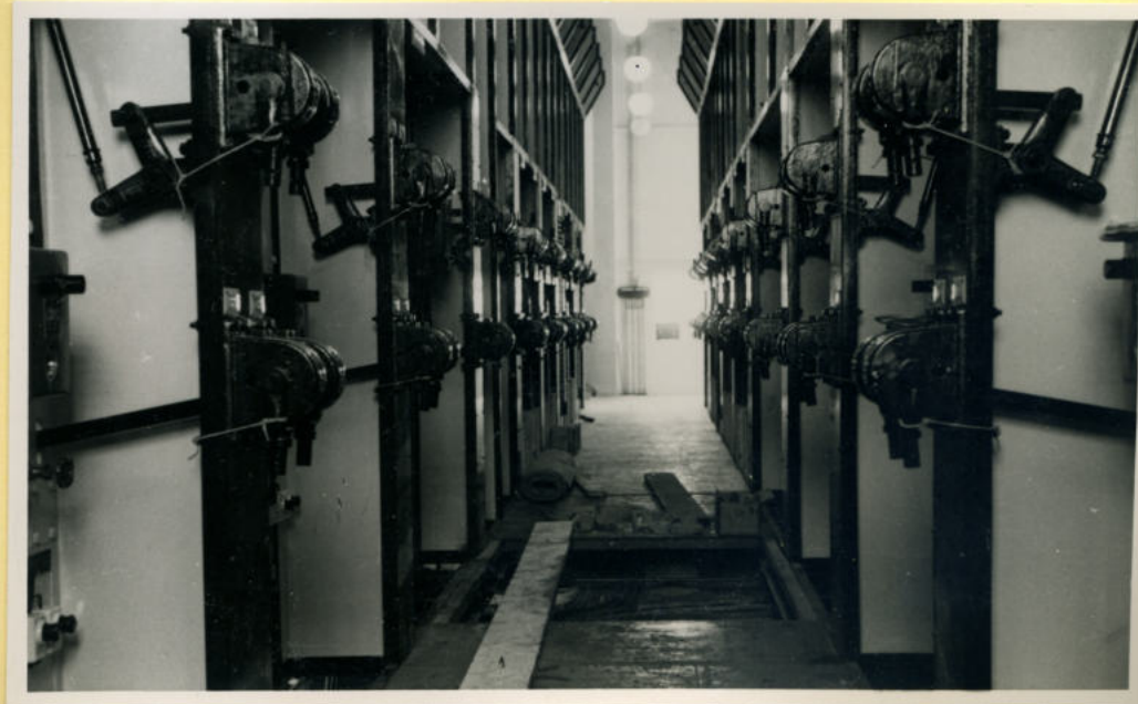
Nieuw turbinegebouw. Hoogspanningsruimte.
