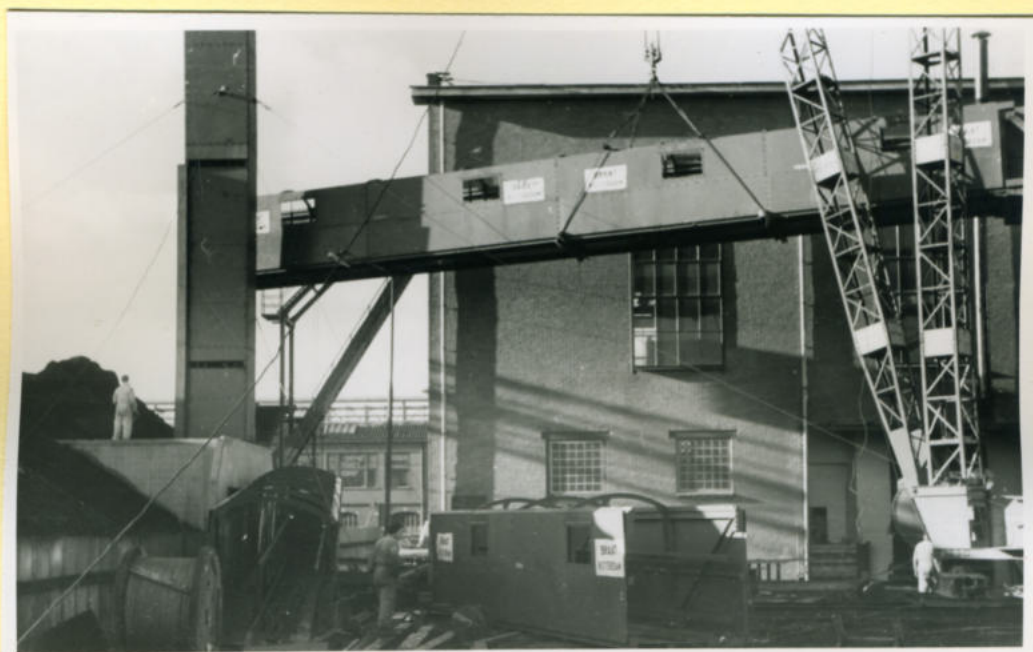
Kolentransport Ketel 8. Tunnel gaat omhoog.
